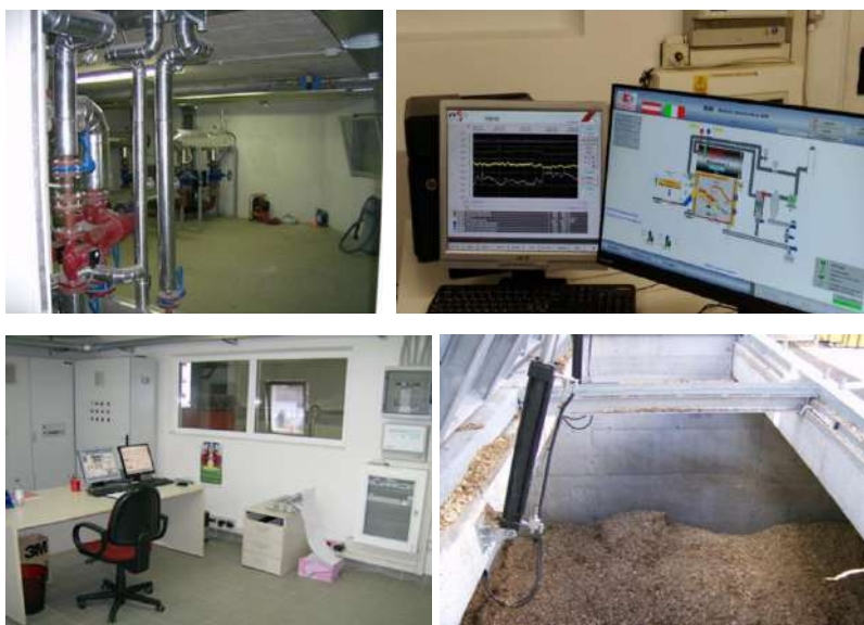
Centrale a biomasse. Centro di controllo e deposito cippato.
